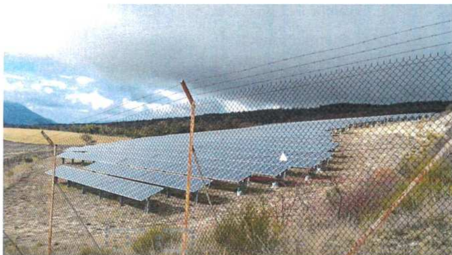
Centrale photovoltaïque au sol sur Ferrassières
